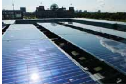
Solaranlage auf dem Dach des Bundeskanzleramtes Quelle: Bundesbildstelle Bionert
