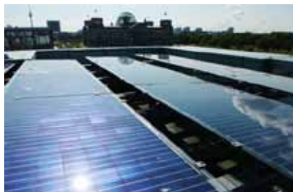
Solaranlage auf dem Dach des Bundeskanzleramtes Quelle: Bundesbildstelle/Bienert
